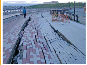
護岸近くの歩道の不陸
