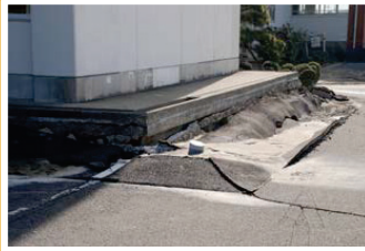
杭基礎構造物周辺の地盤沈下
