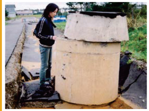
マンホールの浮き上がり
